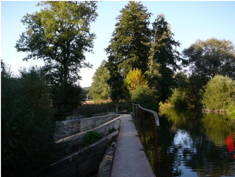
Náhon malé vodní elektrárny
