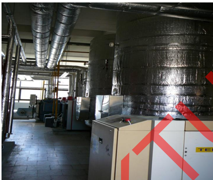
Kotelna s kogenerační jednotkou v popředí.
