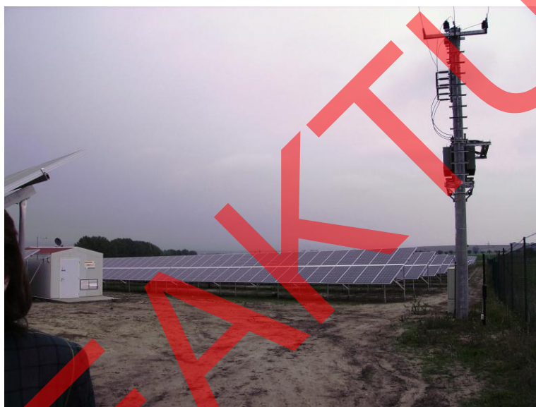
Řada fotovoltaických panelů s trafostanicí
